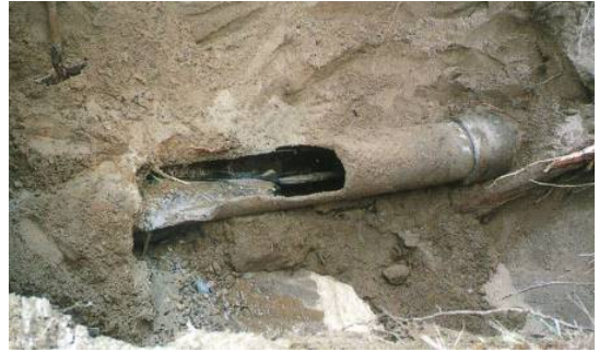
石綿管の破損状況
