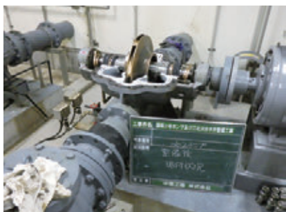
羽根車をセットしたらパッキン等の消耗品を取り付けていきます。
