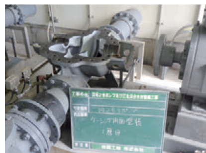
ポンプ内の羽根車等を撤去したあとケーシング内面を塗装しています。
