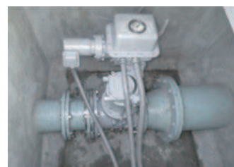
【整備後の分水弁】
